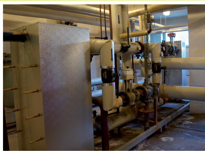
Nowoczesny węzeł cieplny Modern heating hub
